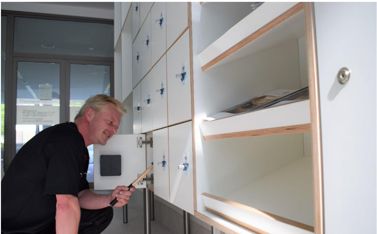
Stefan Hermann aus Bad Elster bei der Endmontage der neuen Schließfächer für die Besucher der Soletherme Bad Elster Foto: SSB / LM
